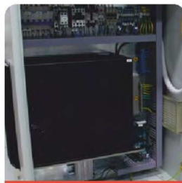
Щит источника бесперебойного питания (ЩИБП)
