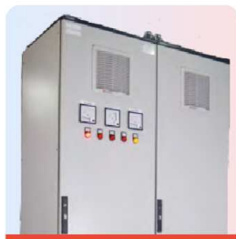
Шкаф оперативного постоянного тока (ШОТ)
