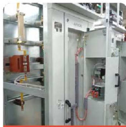
Распределительное устройство низкого напряжения РУНН
