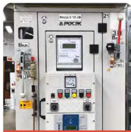
Распределительное устройство высокого напряжения РУВН
