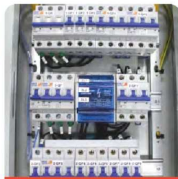
Щит собственных нужд (ЩСН)
