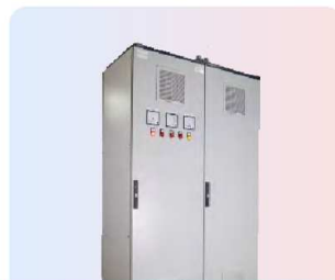
Щафы управления и автоматики (ШУиА)
