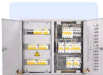
Щиты освещения (ЩО, ЩОА)
